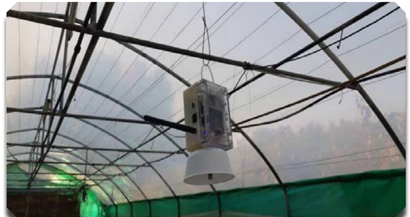
سامانه هشداردهنده نصب شده در گلخانه
