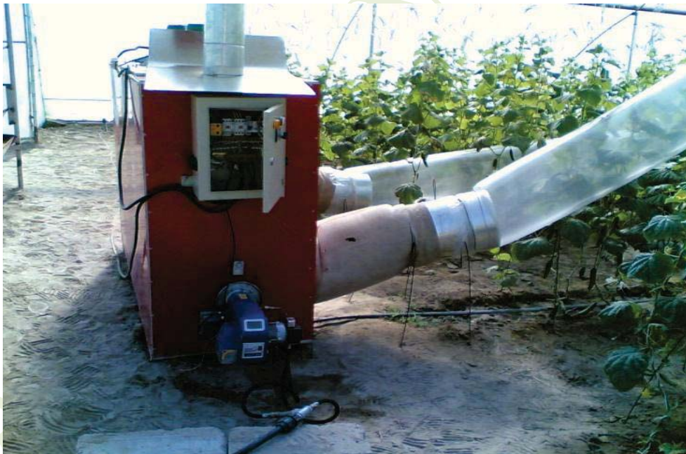
شکل ۲- استفاده از کوره هوای گرم در گرمایش گلخانه تولید خیار.
